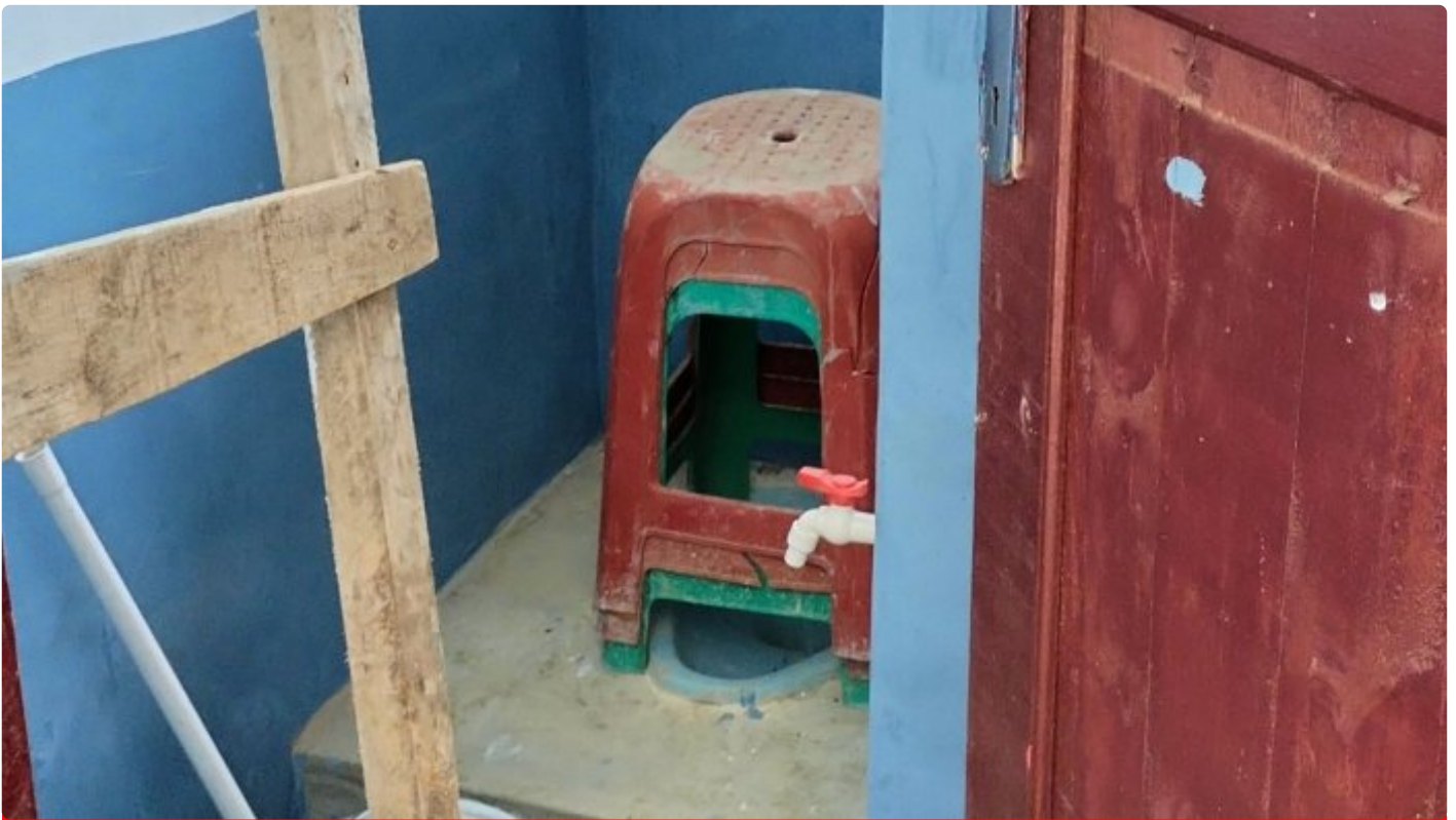
Kondisi toilet (jamban) SMPN Satap 1 Dolat Rakyat, Kecamatan Dolat Rakyat, Kabupaten Karo seharga Rp.169 juta
